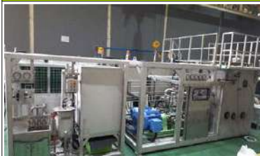
원자로냉각재펌프 내장품 화학제염설비
